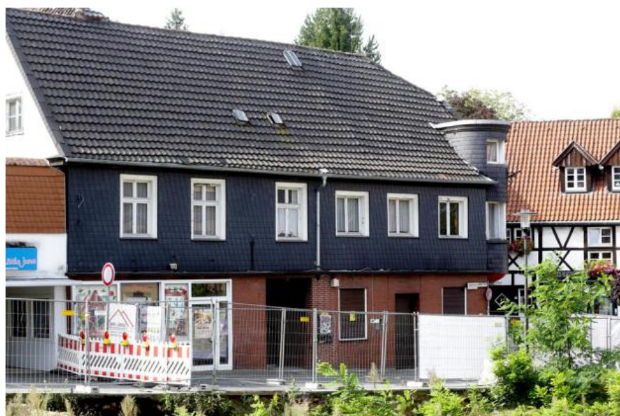
Das marode Eckhaus an der Johannes-Janssen-Straße wird jetzt abgerissen, auf dem Grundstück baut Dr. Werner Jerke ein Privatmuseum für polnische Gegenwartskunst. Foto: Thomas Nowaczyk
